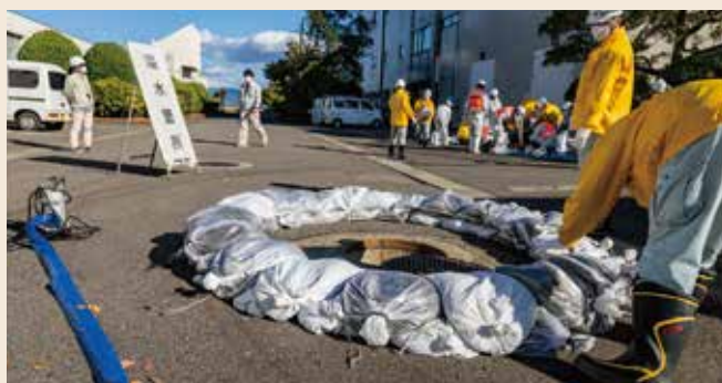
溢水箇所 土嚢設置
